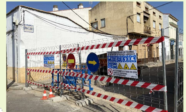
Ilustración 22. Obras de regeneración de la red de abastecimiento en Calle Miraflores. Ayuntamiento de Villanueva de la Serena
